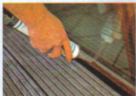
Der letzte Schritt: In einem Durchgang wird die Scheibe auf der Außenseite mit Silikon verfügt.
