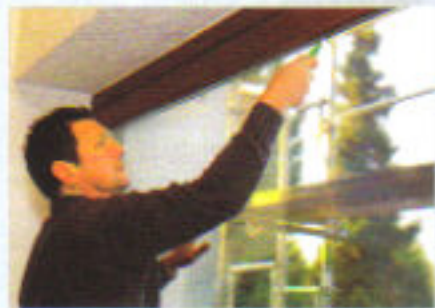
Die Demontage der alten Scheiben: Zunächst werden die Leisten auf der Rauminnenseite vorsichtig gelockert und abgeholt.
